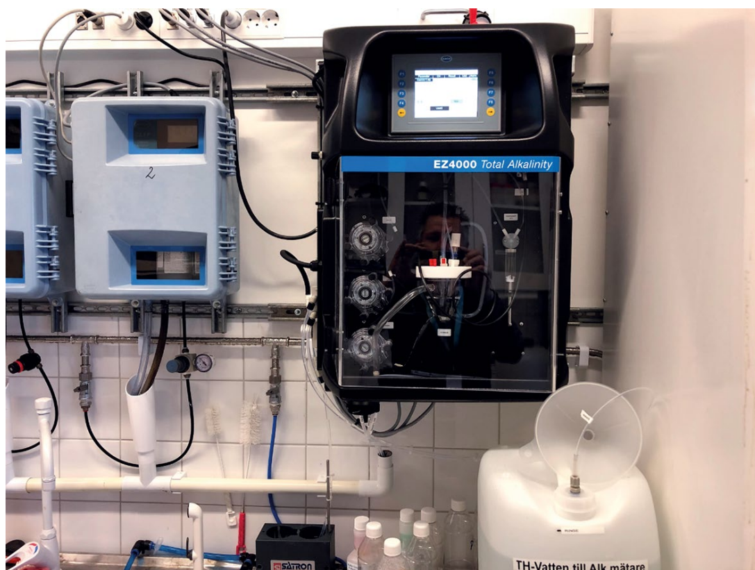
Instalación del analizador de alcalinidad total EZ4000 en la planta de tratamiento de aguas de Vomb
